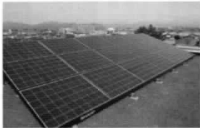
当校に設置した太陽光パネル
